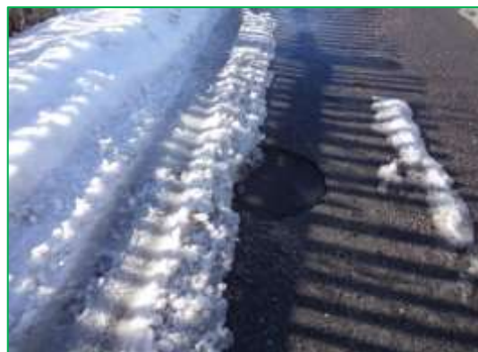
Výtluky cest se objevují po celé obci
